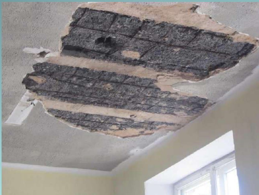
Обрушение бетона защитного слоя на отдельных участках. Поверхностная коррозия стальной арматуры высокой степени интенсивности.
