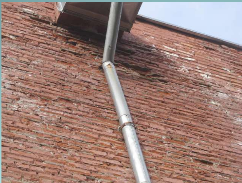
Размораживание кладки на глубину до 40 мм на многочисленных участках; высолы на поверхности кладки
