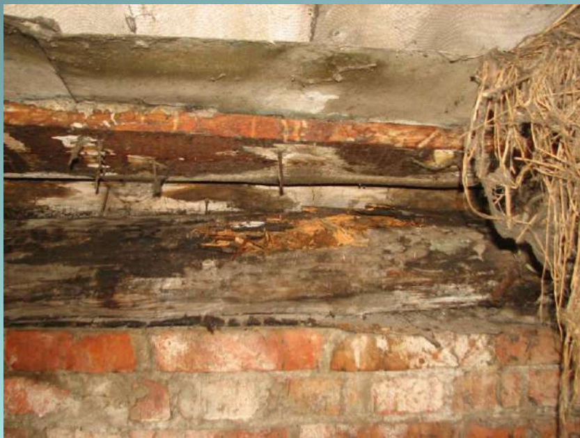
Массовое поражение и разрушение древесины маузрлата дереворазрушающими грибами (гниль)
