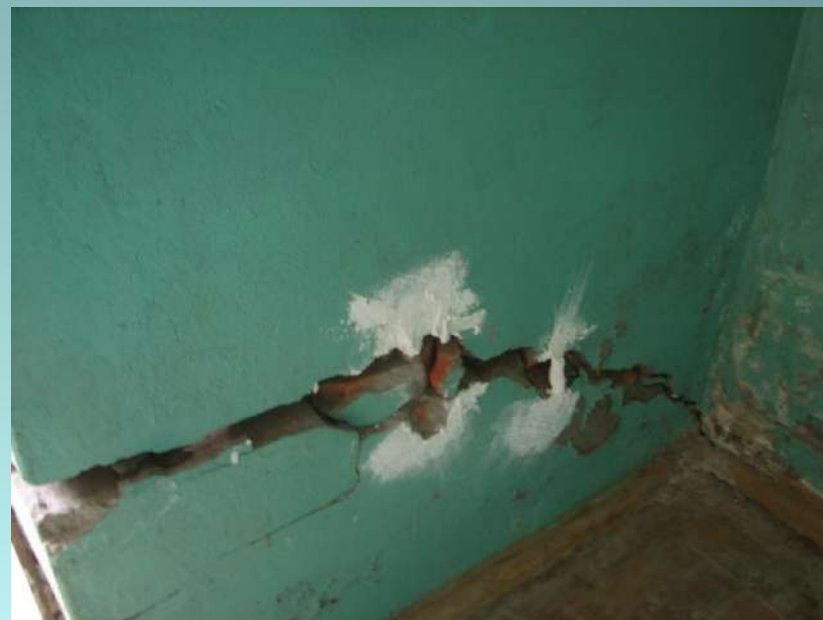
Сквозная наклонная трещина шириной раскрытия до 30 мм по внутренней несущей стене
