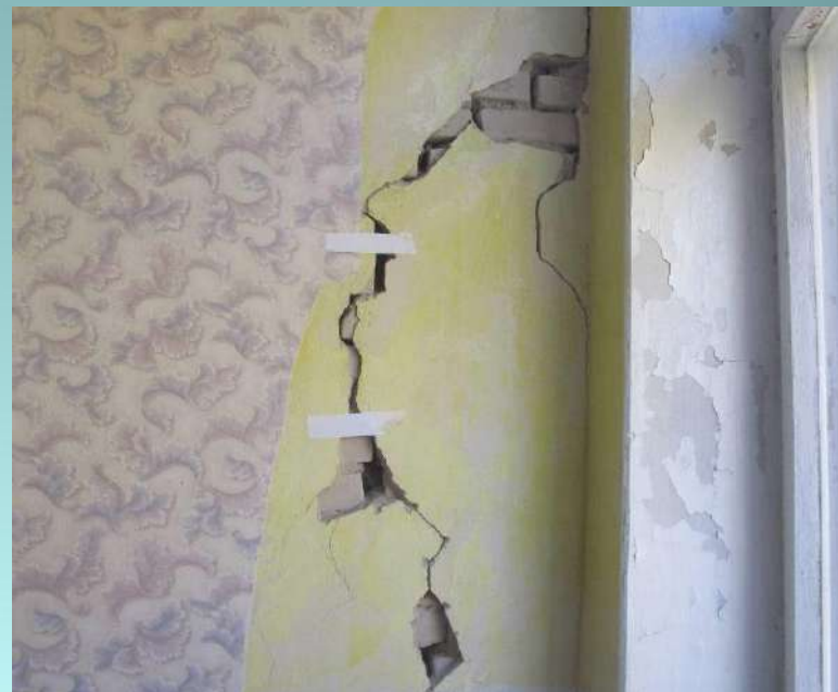
Наклонная трещина по швам кладки шириной раскрытия до 8 мм по самонесущей стене. Некачественная установка маяков
