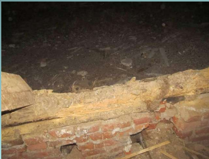
Массовые разрушения древесины лежня древоточцами на всю толщину
