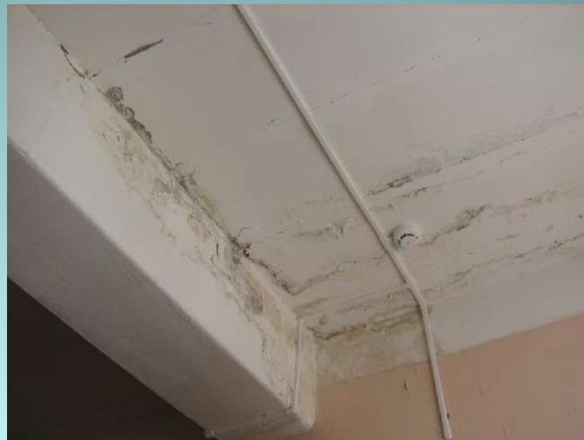
Следы увлажнения несущих элементов покрытия. Биоповреждения (грибок) на многочисленных участках
