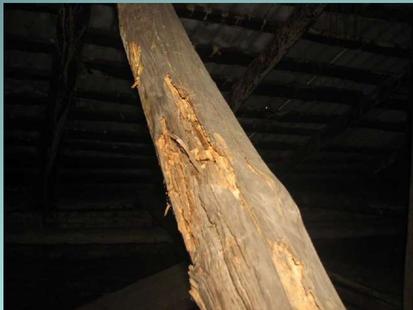
Разрушение древесины подкоса дереворазрушающими грибами на многочисленных участках (сухая гниль)
