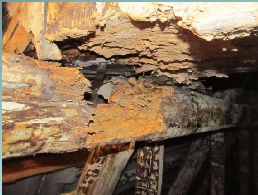
Полное разрушение древесины прогона деревообразующими грибами (гниль на всю толщину)
