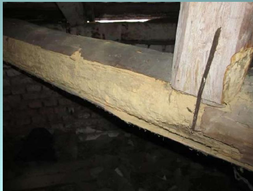
Массовые повреждения древесины нижнего пояса шпренгельной фермы дровоточцами
