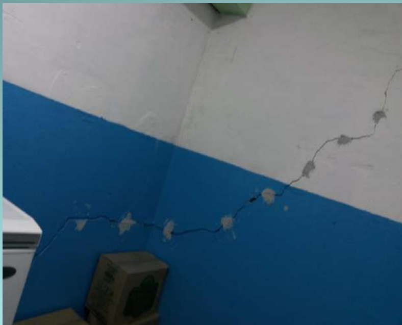
Наклонная трещина шириной раскрытия до 10 мм переходящая с несущей на самонесущую стену. Некачественная установка маяков
