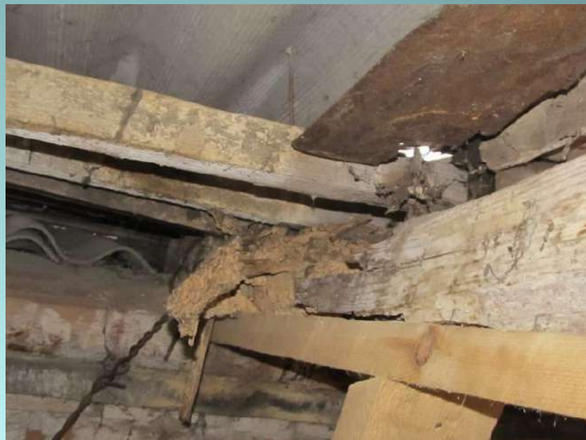
Полное разрушение древесины дереворазрушающими грибами (гниль) в заделке стропильной ноги
