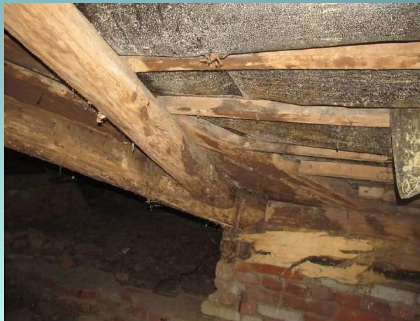
Массовые разрушения древесины мауэрлата древоточцами на всю толщину
