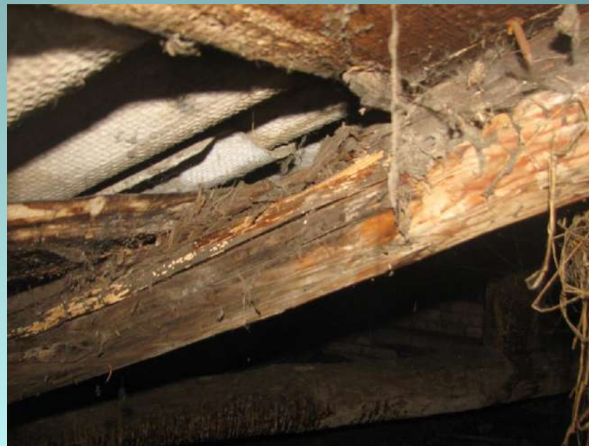
Продольная трещина шириной раскрытия до 5,0 мм; разрушение древесины стропильной ноги дереворазрушающими грибами (сухая гниль)
