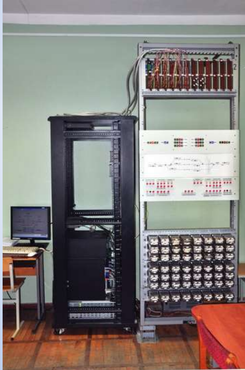
ДЦ «Неман». АРМ ДСП и комплект линейного оборудования с автоматическим оборудованием (ауд. 1319)
