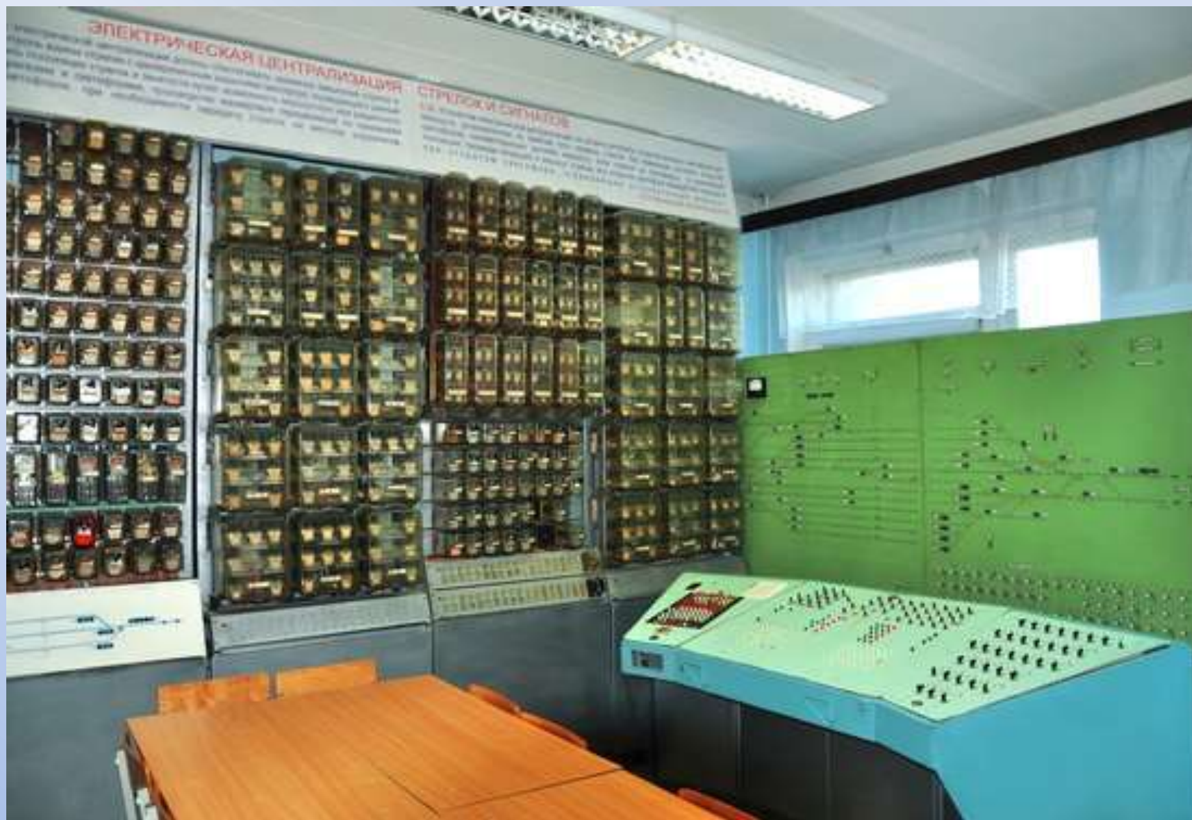
Лабораторный комплекс «Блочная маршрутно-релейная централизация» (ауд. 1317)
