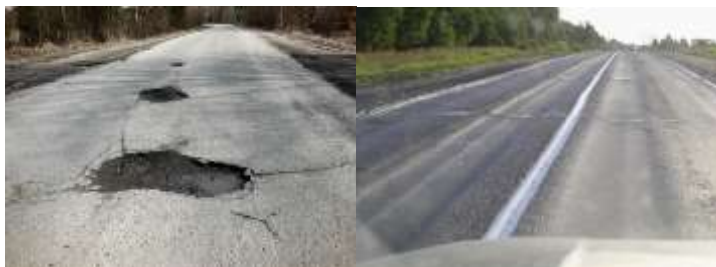
Рисунок 1 – Дефекты покрытий, такие как ямы и колеи
